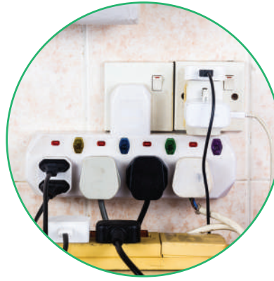
توصيل عدّة أسلاك لأجهزة كهربائية متعدّدة بمقبس واحد مصدر خطر.
