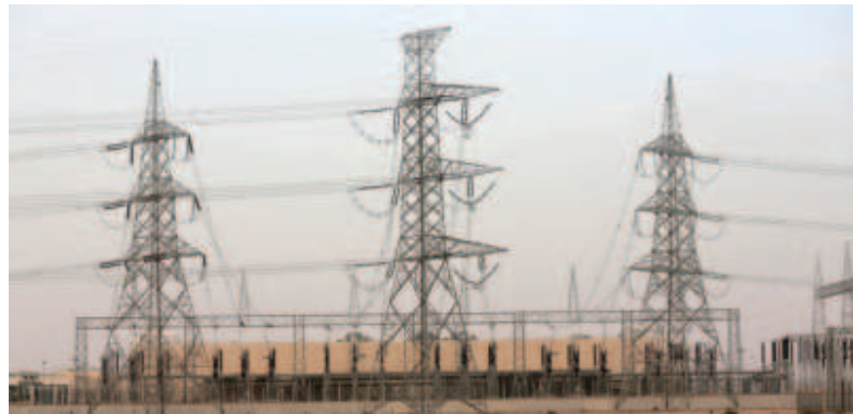
محطة سدبر لتحويل الكهرباء
