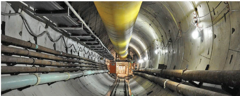
الشكل (1): قناة تحت سطح الأرض ذات حجم كبير تحتوي على عدة شبكات بداخلها وتخدم أحياء المدينة.
