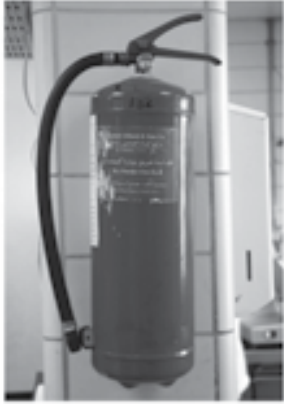
الشكل (٢-٢): طفاية حريق.
